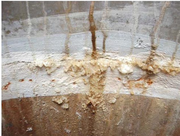
写真No.1 斜壁目地 クラック・浸入水 C
