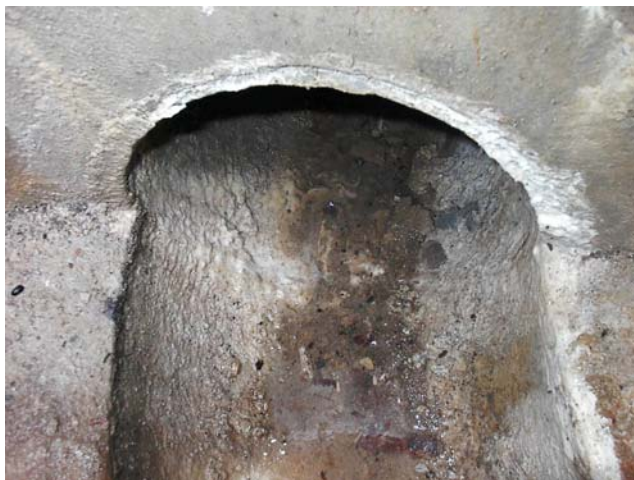
写真No.3 下流管口 浸入水 C
