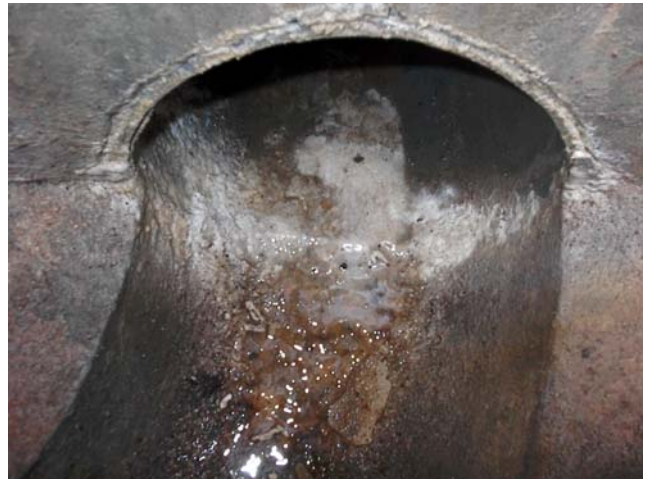
写真No.2 上流管口 浸入水 C
